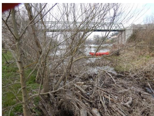
Figure 34 : Embâcle bloquant l'entrée amont de la frayère 5340
