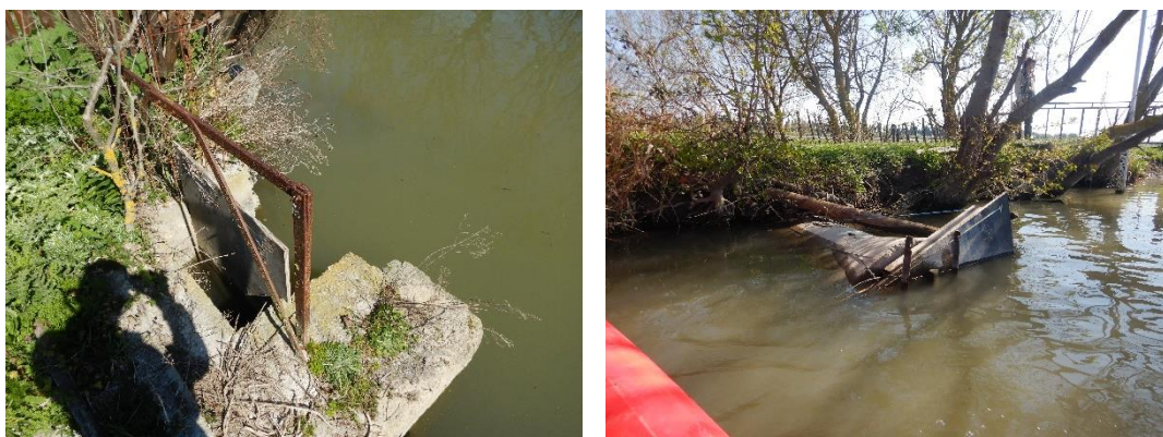
Figure 86: Vannes fonctionnelles ou cassées reliant le Vieux Vistre aux canaux/prairies inondées
